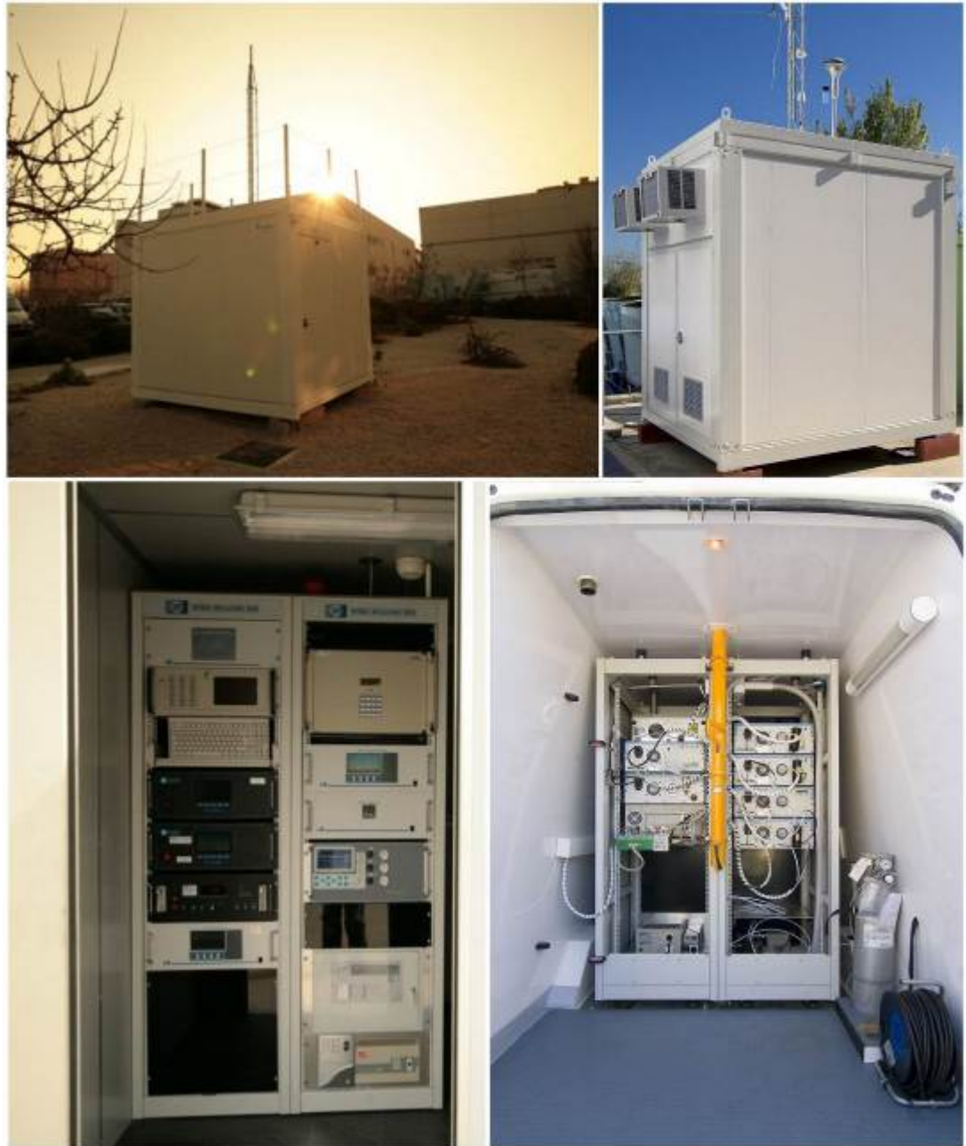
Figura 24. Cabinas de monitoreo equipos automáticos
